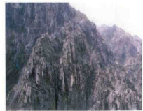
荒廃状況(松木川)
