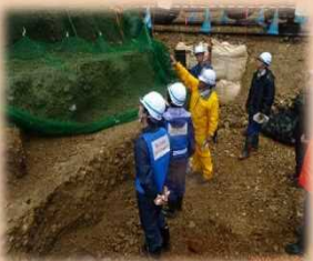
現場体験:建設中の砂防ダム現場を見学(現地材料を有効活用する「INSEM工法」)
