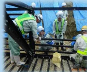
現場体験:建設中の砂防ダム現場で鋼製杭の組み立て作業を体感
