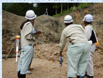
レーザーレベルでの測量体験 (滝沢第2砂防堰堤工事現場)
